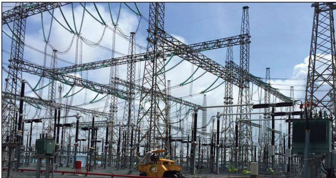
TRẠM BIẾN ÁP 500KV DUYÊN HẢI
