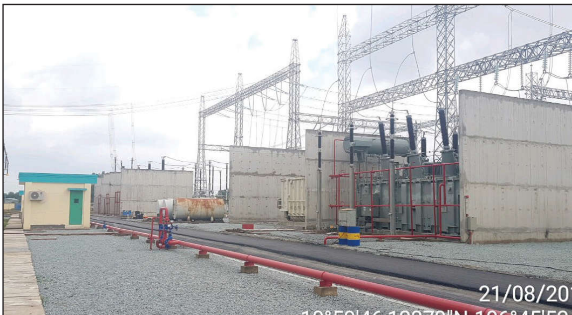
TRẠM BIẾN ÁP 500KV TÂN UYÊN
