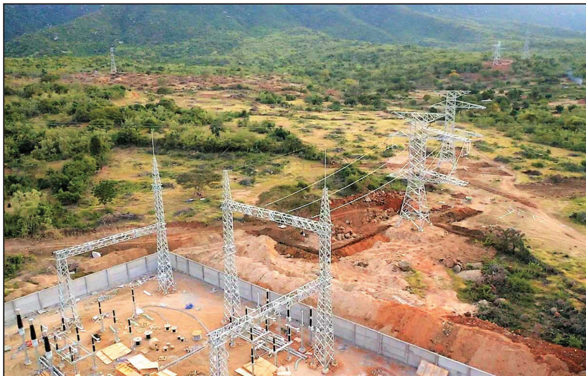
NHÀ MÁY ĐIỆN MẶT TRỜI THUẬN NAM ĐỨC LONG - NINH THUẬN
