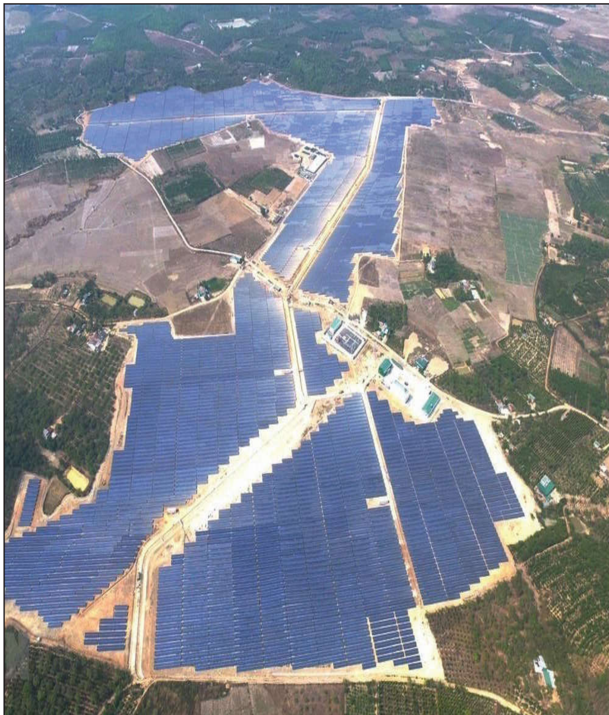
NHÀ MÁY ĐIỆN MẶT TRỜI CỰ JÚT
