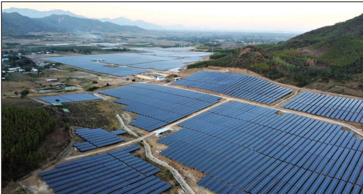
NHÀ MÁY ĐIỆN MẶT TRỜI MIỀN TRUNG - KHÁNH HÒA
