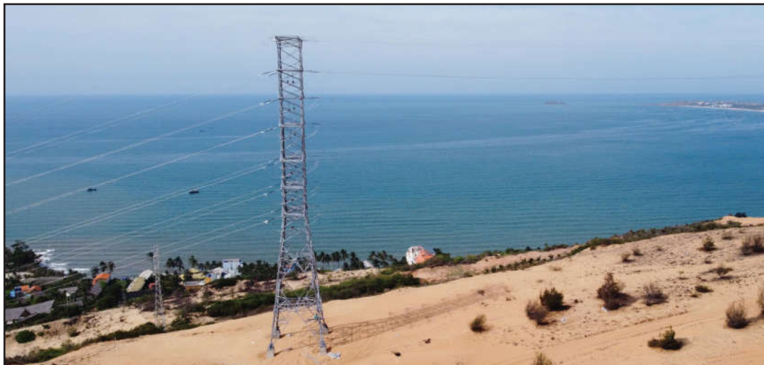
Đường dây đấu nối Nhà máy điện gió Thuận Nhiên Phong vào trạm 110kV Mũi Né
